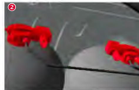
2 Absperrventile der Gastanks lokalisieren und
